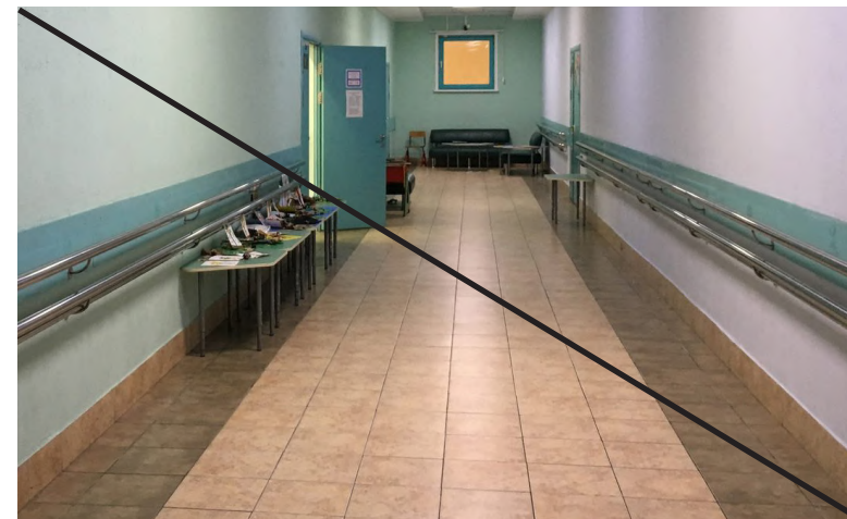
Плохо Керамогранитная плитка с крупными швами
